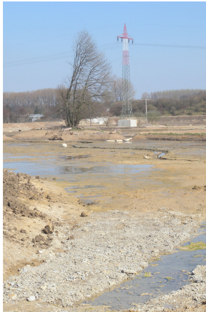
In Oelde werden derzeit Hochwasserrückhaltebecken gebaut, die in weiten Bereichen wie eine Aue ausgeprägt sind.
